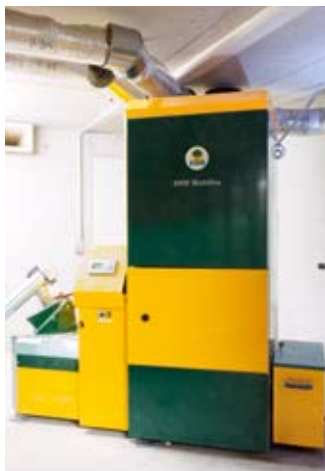
Der Holzpelletsessel dient der Spitzenlastabdeckung im Schulzentrum
